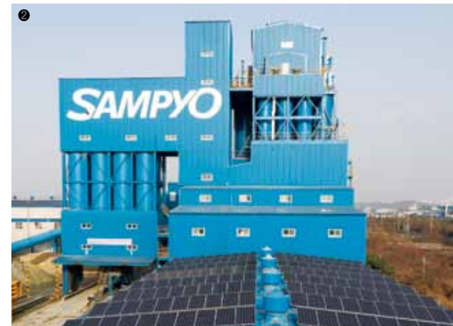
1. 지난 10개월간 태양광 사업의 기반을 다져온 삼표기초소재(주) 신사업팀 김승배 팀장(좌), 박준형 대리(우) 2. (주)삼표산업 인천물탈 공장 옥상에 설치된 태양광 패널
